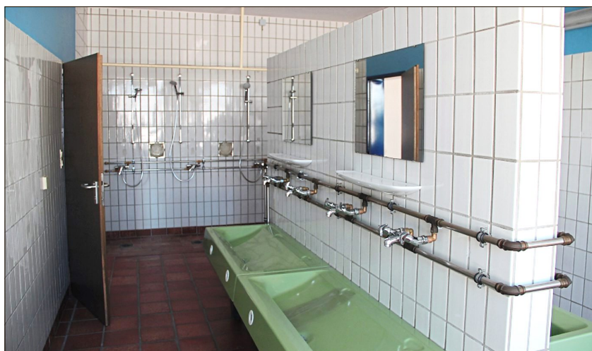
Den Asylsuchenden stehen Gemeinschaftswaschräume zur Verfügung. Dafür wurden unter anderem die Leitungen in den Nasszellen erneuert. (Foto: kh)
